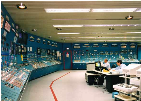
Sala de Control de la Central Nuclear Embalse (1984) ubicada en la provincia de Córdoba, de 648 MWe de potencia eléctrica.
