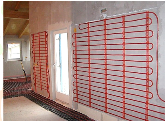
Fig. 1 - Sistema radiante TABS instalado sobre las paredes de una vivienda.
