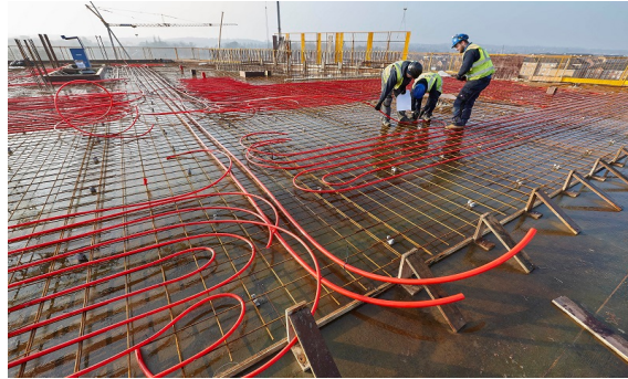
Fig. 3 - Universidad de Northampton (Gran Bretaña). El edificio cuenta con 40 km de tubos TABS instalados en sus diferentes pisos y techo. (Gentileza: REHAU)
