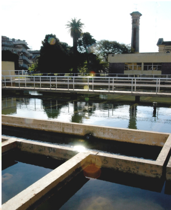
Figura 2: Filtros de la Planta Potabilizadora General San Martín (Foto Gentileza AySA)
